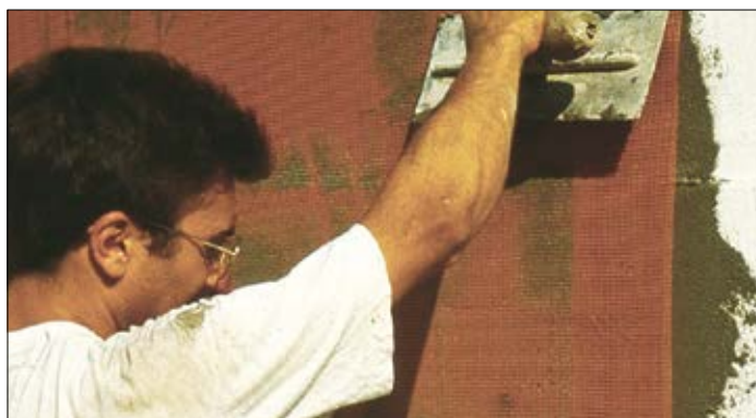
Stesura secondo strato di malta adesiva con annegata la rete di rinforzo.
