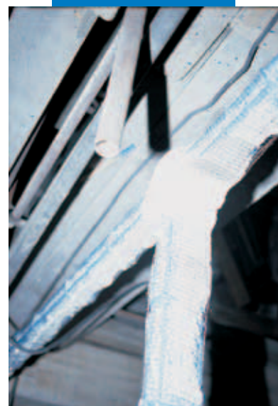
Struttura in calcestruzzo degradato
