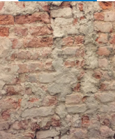
Supporto disomogeneo da risanare
